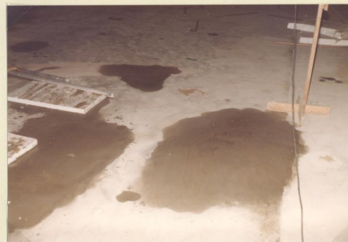
26.11.83 Ser ut som det er vanngjennomslag gjennom hallgulvet.
