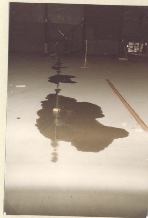
31.12.83. Ute var kraftig mildvær og gjennom skjøten i gulvet kommer vann opp.
