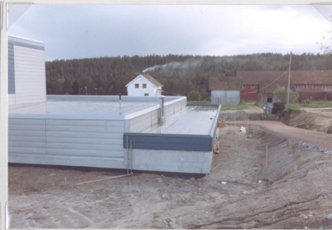
14.6.84 Ser ut som taket har ikke den rette fall.
