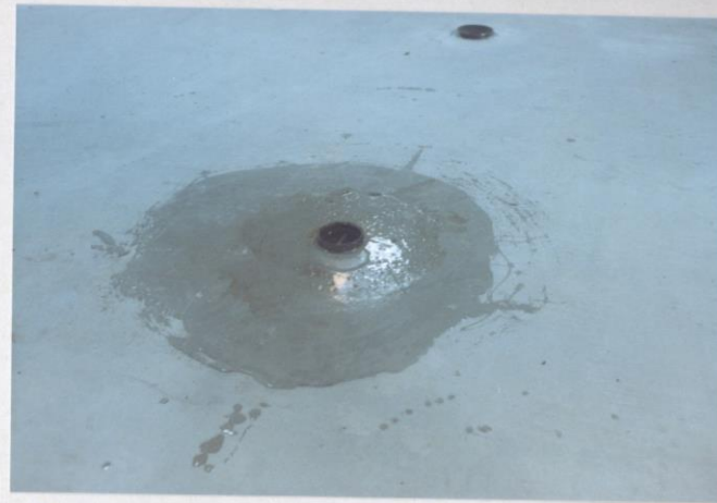
8.10.84 Det er ennå vann rundt ene av rørstussene.
