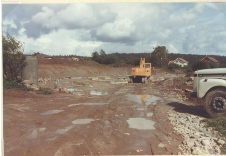
1.7.83. Den krabben som er kjørt på anleggsveien er etter regneraret en eneste mörpe og når tørker igjen er det bare støv.
