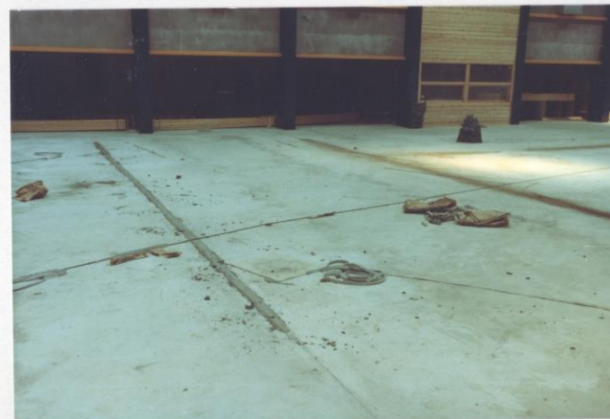
14.5.84 Mer "Klitting" av sprekkene
