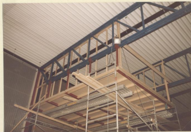
16.12.83 Varmefordelingsrommet under tak
