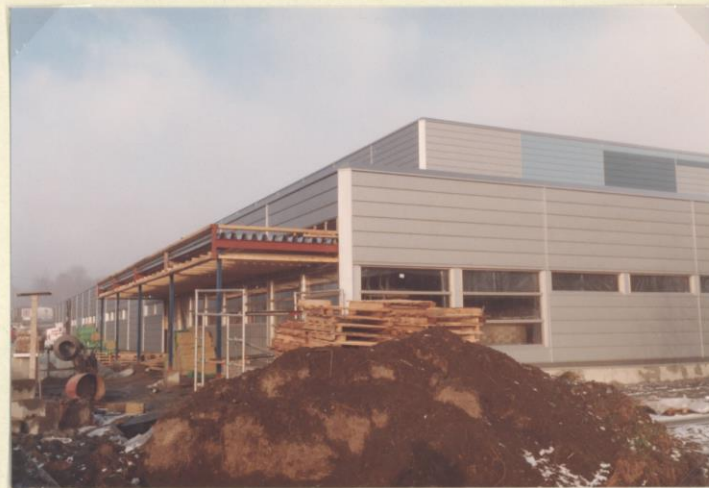
11.11.83 Tak over inngang
