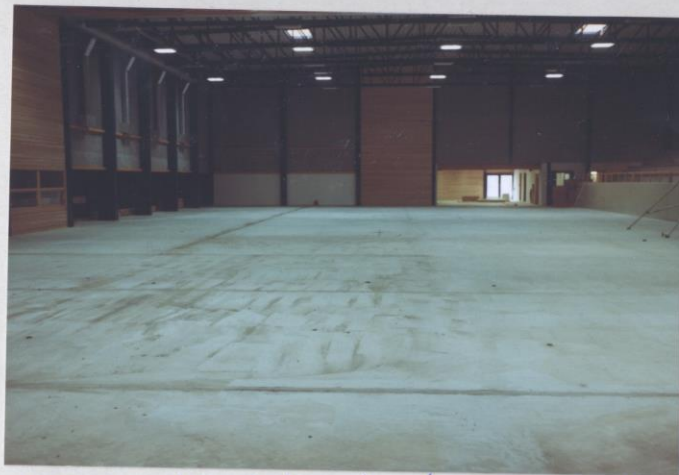
25.5.84 Hallgulvet ser fin ut, men golvskjøtene sees tydelig og noen steder presser vannet opp.
