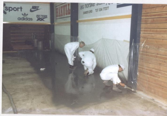
1.12.84 Inspeksjon etterpå viser overraskelse. Belegget har ikke delvis festet seg på gulvet.
